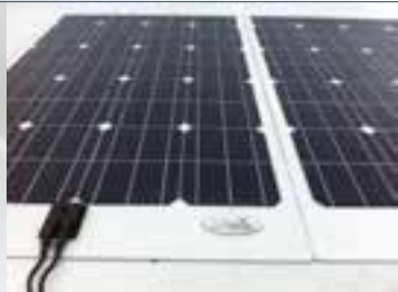
Solcellerne monteret på taget. Bemærk hvor tynde de er.
