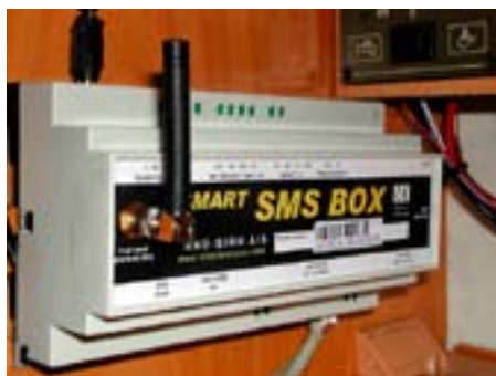
SMART GSM Box monteret i pågældende campingvogn.
